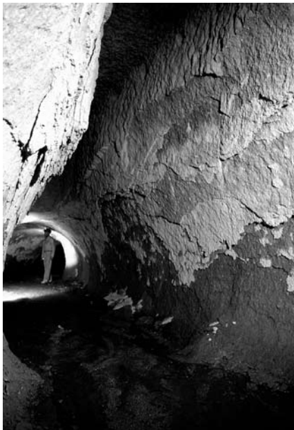
Fig. 9 - Valle di Meskendir (Cappadocia). L'azione di erosione millenaria in un cunicolo di drenaggio scavato dall'uomo ha comportato una profonda reincisione dell'opera idraulica la cui sezione originaria è in parte rimasta sospesa sulla volta della cavità (Foto G. Bologna). Nel caso specifico il rimodellamento della sezione è dovuto anche a processi di esfoliazione per gelivazione.
