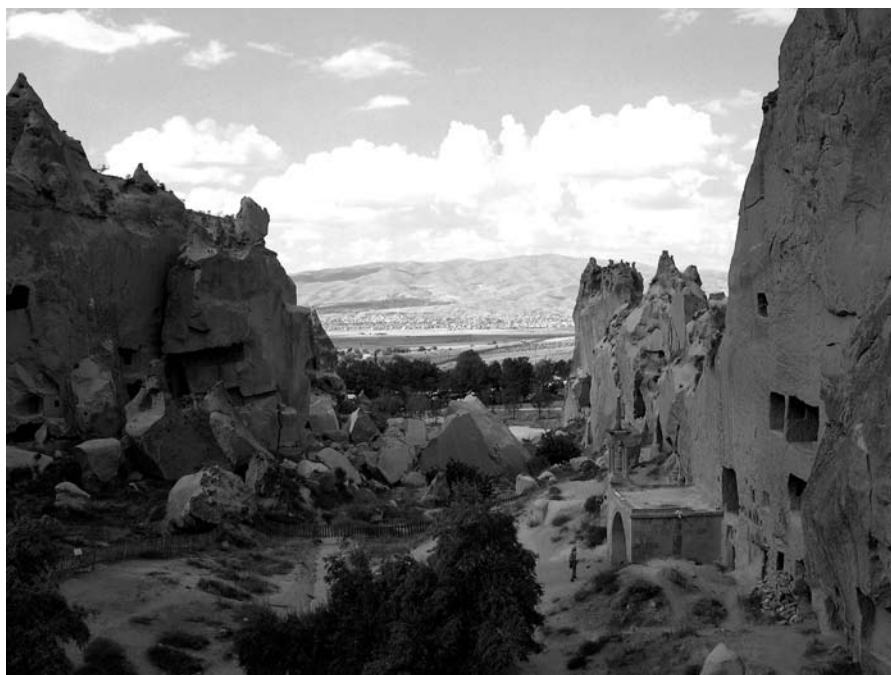
Fig. 18 - Frattura da detensionamento molto ampia ed estesa su tutta la porzione della falesia tufacea già interessata da pregressi fenomeni di crollo che hanno messo in luce i vani sotterranei scavati nel versante (foto: R. Bixio - Centro Studi Sotterranei). L'ulteriore evoluzione della frattura porterà nel tempo al collasso anche di questa porzione di versante e degli ipogei in esso presenti.
